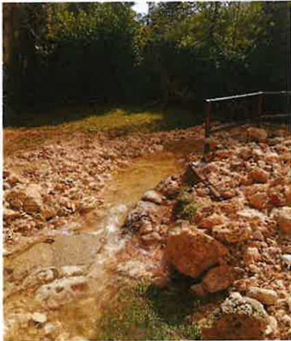
Foto 1 24.09.2024, vista del ramo a destra idrografica della Roggia Scandolara verso valle che evidenzia abbondante materiale detritico ostruente la sezione idraulica.
